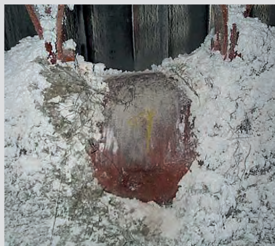
Fotografía tomada en el interior del "penthouse" de la caldera de licor negro de la papelería de ENCE en Navia (Asturias).
